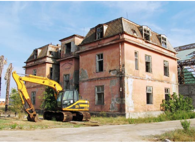
Verfall mit Kalkül: Alles deutet darauf hin, dass der Salzgarten gezielt heruntergewirtschaftet wurde. Im Bild das Verwaltungsgebäude der Saline.
