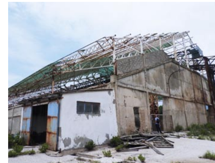
Die Saline von Ucinj war eine der größten an der östlichen Adria und bedeutete eine sichere Einkommensquelle für die Menschen in der Region. Heute sind die Salinengebäude verlassen und verfallen.
